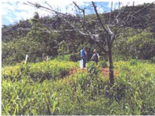
Foto 7.-Torre T266 construida sin monitoreo arqueológico.
