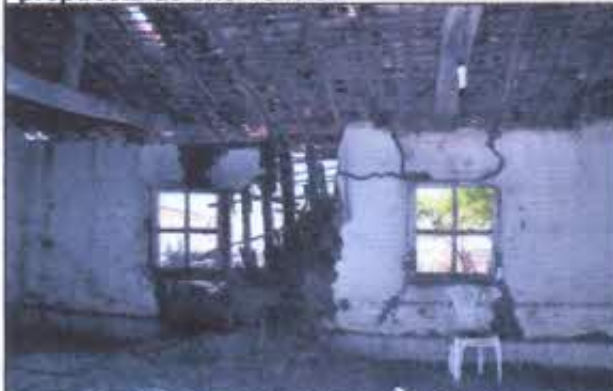
Foto 5: Estado actual del inmueble. Deterioro de muros y cubierta.
