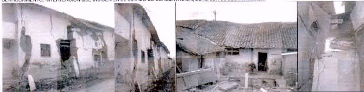
EDIFICACION CON DESCONFINAMIENTO DE LA CIMENTACION. ASENTAMIENTO DE MURO MAESTRO EXTERIOR, CUBIERTA
